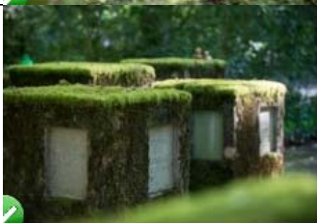
Bild 6 Die 1972 in Betrieb genommene Urnennischenanlage heute – von Moos überwucherte Betonkuben.
