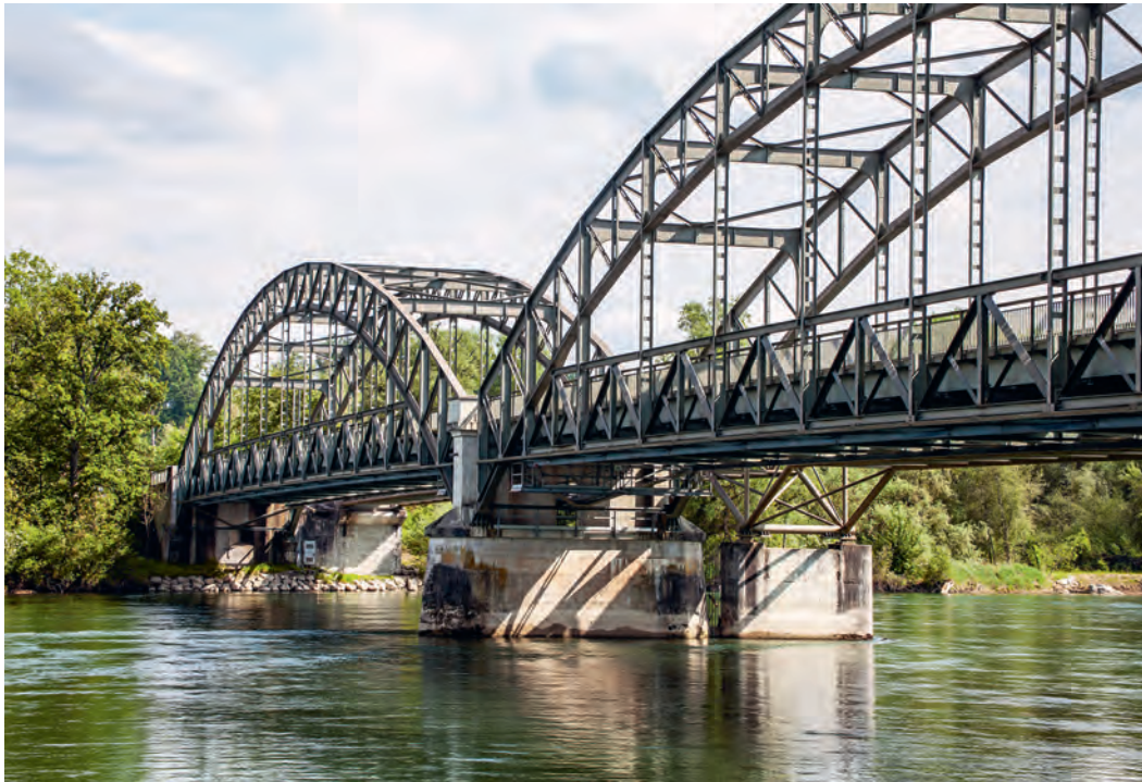
ABB. 320 Koblenz. Strassenbrücke Koblenz–Leuggern von 1935/36, bestehend aus zwei markanten Stahlfachwerkbogen, in denen die Fahrbahnplatten eingehängt sind. Foto DPAG, Roger Wehrli, 2022.
