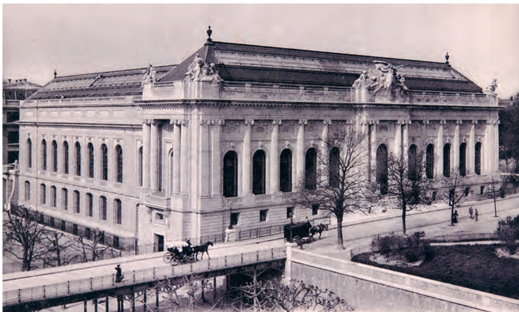
FIG. 306 Rue Charles-Galland 2. Musée d'art et d'histoire. Construction du portique et d'une tour de l'angle destinée à contenir un escalier de service, 20 mai 1904. Au fond, les murs de moellons, pas encore enduits, contrastent avec la pierre appareillée des piles et des arcs. Photo anonyme. Archives Architectures [CH CH-000419-1 CAM-doc-1902/02-3-1-14].
