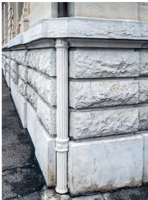
FIG. 394 Place René-Payot 1/rue du Conseil-Général 4. Édifié en 1870, le bâtiment a conservé ses descentes d'eau pluviales en fonte, à l'angle d'un soubassement marqué par des bossages rustiques. Photo Peter C. Taylor, 2024, IMAHGe.
